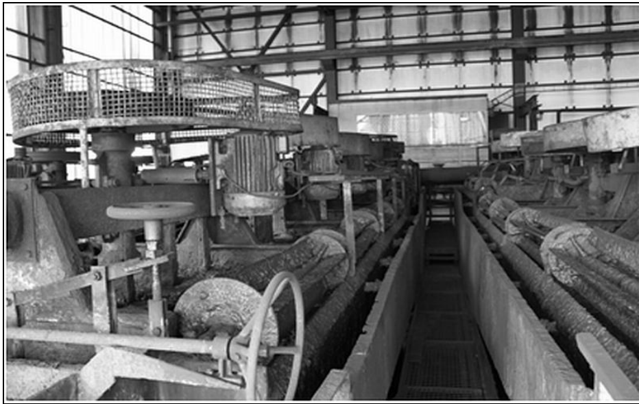
Rys.2. Widok maszyn flotacyjnych IZ-5 [4]
